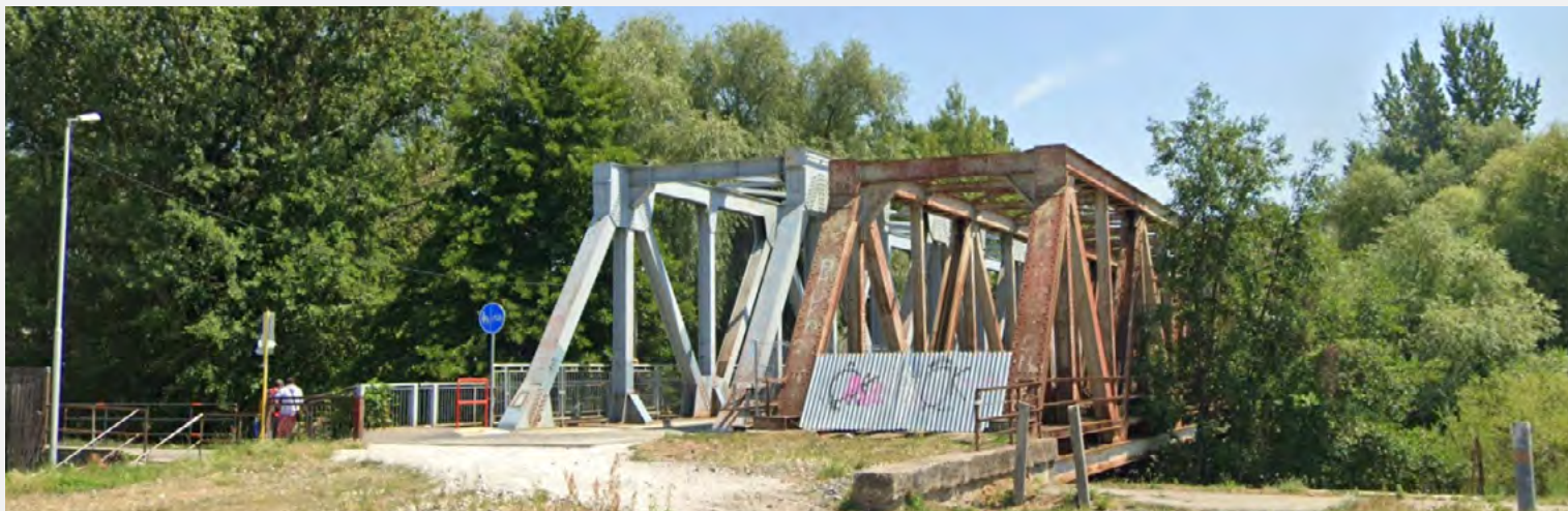
↑ Foto súčasného stavu. Jedná sa o dva mosty s vykonzolovaným chodníkom, novší most slúži ako cyklotrasa, starší most je bez podlahy, v súčasnosti je uzavretý.
